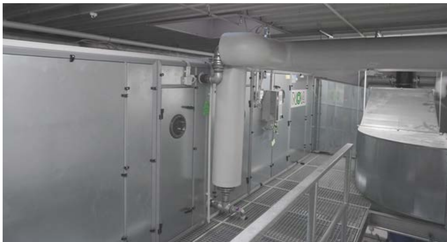
Abwärme der Abwasservorbehandlung und des Einbrennofens wird für Heizung und Warmwasser genutzt.
